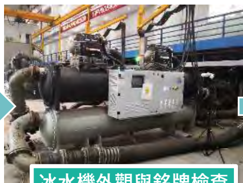
冰水機外觀與銘牌檢查
