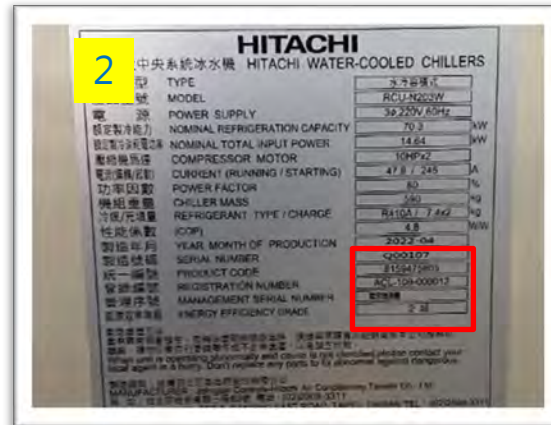
機組銘牌確認
